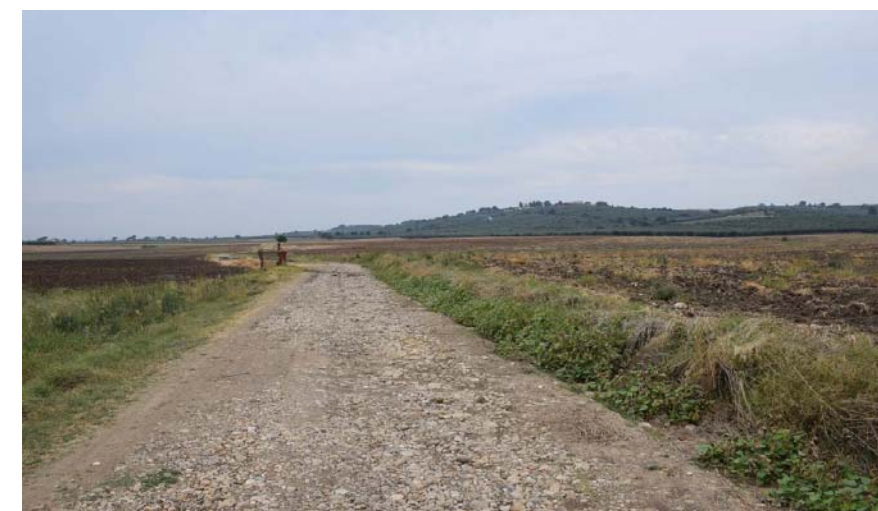
Figura 4 – Strada comunale “Maddalena-Ischia”. Come si scorge dalla fotografia, è evidente la necessità di adeguamento della viabilità esistente.
