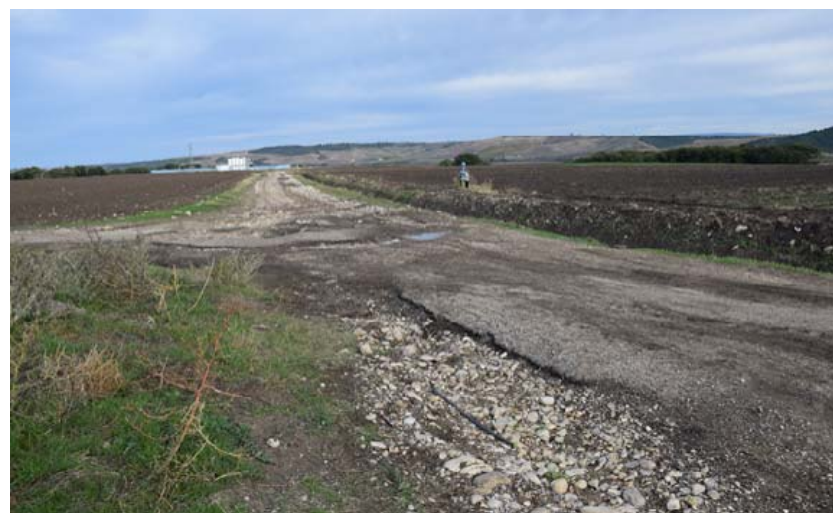
Figura 3 – Incrocio tra strada vicinale “San Paolo” e strada comunale “Difensa”. Come si scorge dalla fotografia, è evidente la necessità di adeguamento della viabilità esistente.
